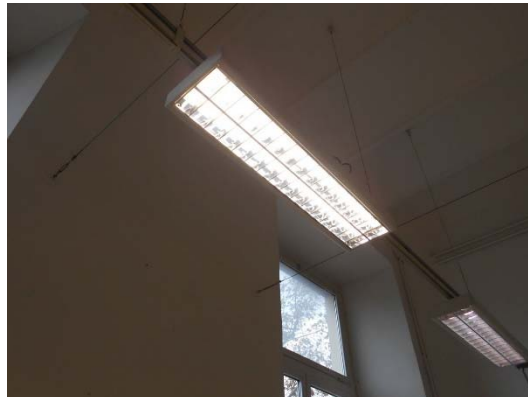
Figura 8.10 - Particolare di una plafoniera a tubi fluorescenti
