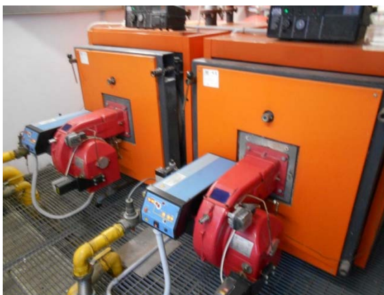
Figura 4.18 - Particolare delle caldaie
