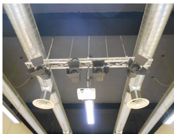
Figura 4.23 - Particolare dei corpi illuminanti ubicati nell'auditorium
