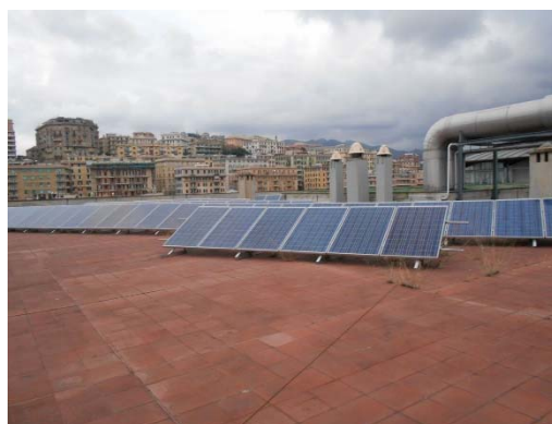
Figura 4.24 - Vista dell'impianto fotovoltaico
