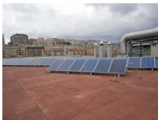
Figura 8.3 - Particolare della copertura con l'impianto fotovoltaico
