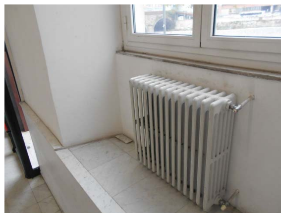
Figura 4.8 - Particolare di un radiatore in ghisa
