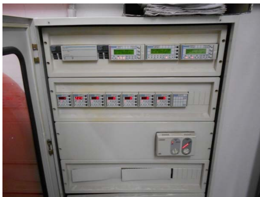
Figura 4.13 - Particolare della centralina di controllo dell’edificio
