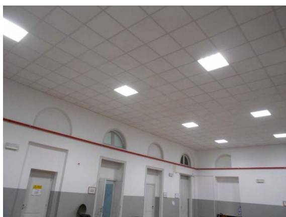
Figura 4.22 - Particolare dei corpi illuminanti ubicati in un corridoio
